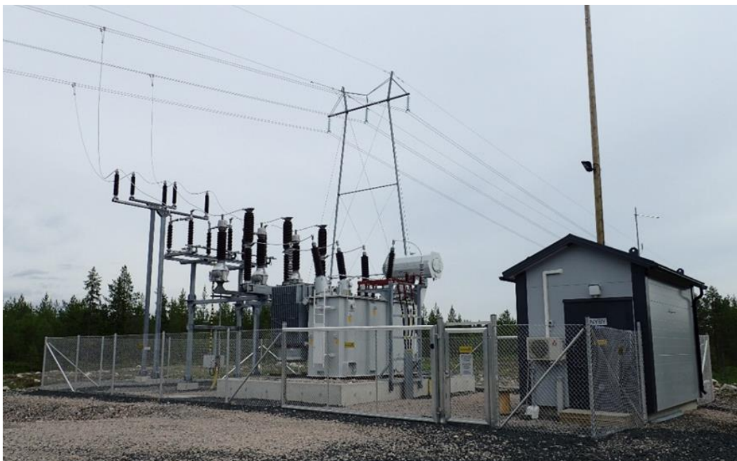
Kuva 17. Esimerkki tuulivoima-alueen sähköasemasta (Kuva: FCG).
